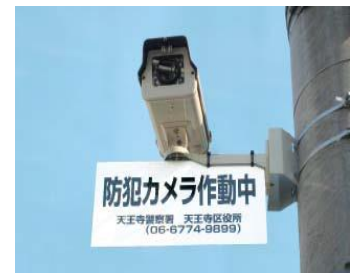
電柱に設置した防犯カメラ
