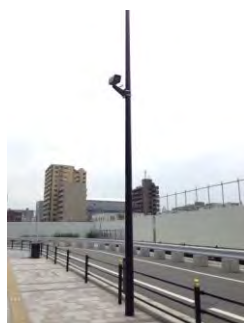
□設置状況(固定型)
