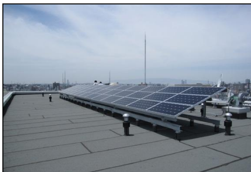
太陽光発電装置（屋上設置）
