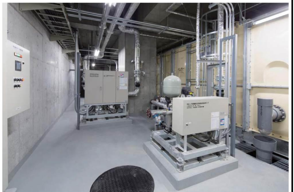
災害時に利用可能な地下の受水槽
