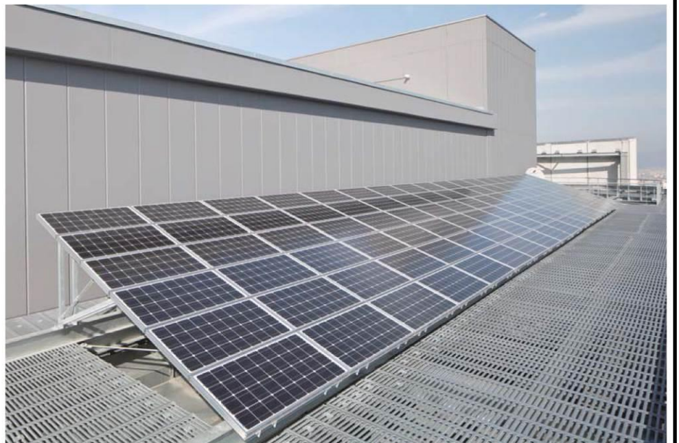
屋上に設置した10kWの太陽光発電パネル
