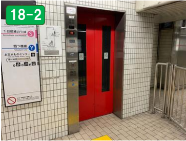
1 天王寺・なかもず方面ホーム内のEV
