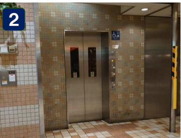
②大阪メトロ谷町線の改札階へのEV
