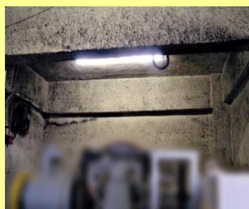
機械室吸音材
