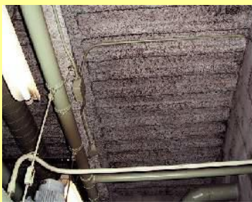
天井断熱材（天井、壁吸音材）
