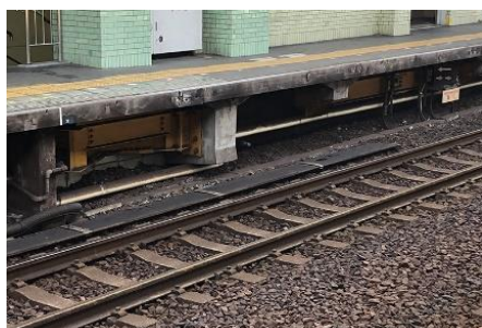
(ホーム転落検知装置)
