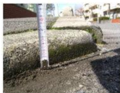
段差 5 cm 大きな段差は危険
