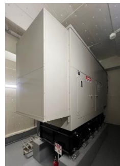
【災害時用発電機の設置】
