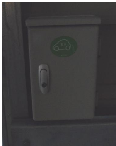
居住者の環境意識を高める設備 ：電気自動車等充電設備
