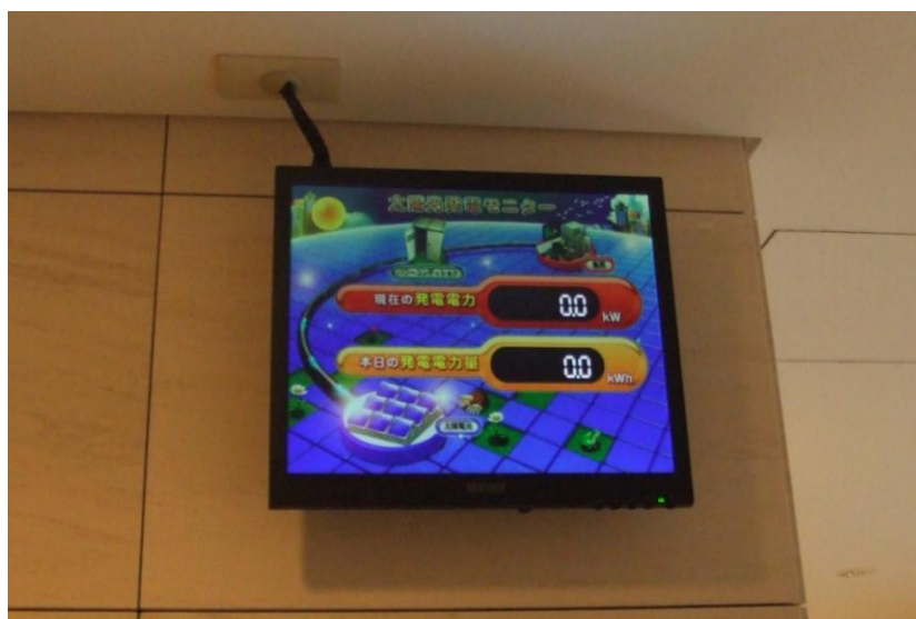
居住者の環境意識を向上させる設備：太陽光発電表示システム
