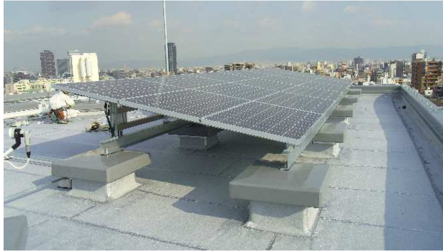
エネルギーを創出する設備 ：太陽光発電システム
