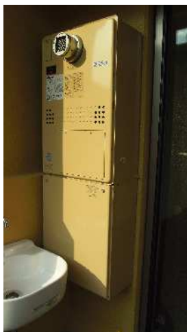
給湯設備 ：潜熱回収型給湯器（エコジョーズ）
