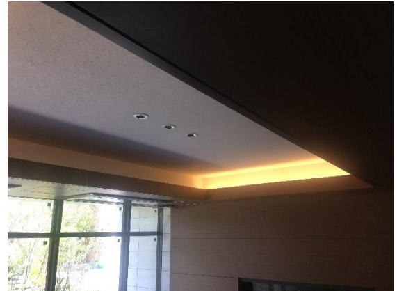
居住者の環境意識を高める設備 共用部分のLED照明
