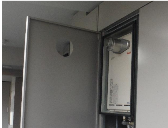
給湯設備：潜熱回収型給湯器
