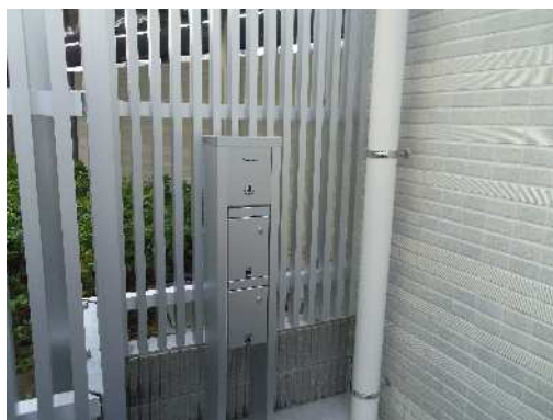
その他の取組み：電気自動車等充電設備
