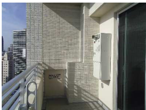
給湯設備：潜熱回収型給湯器（IJS'ヨース'）
