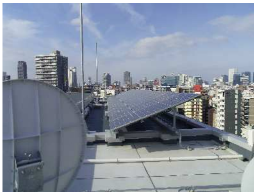
エネルギーを創出する設備 太陽光発電システム
