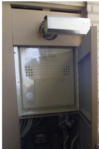
給湯設備 : 潜熱回収型給湯器 (エコジョーズ)
