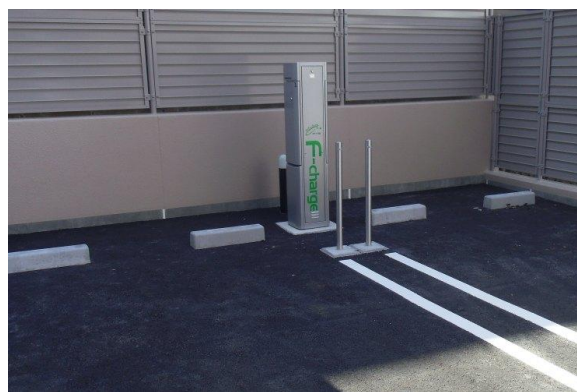
その他の取組み : 電気自動車充電設備
