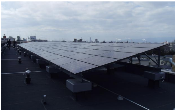
エネルギーを創出する設備 太陽光発電システム
