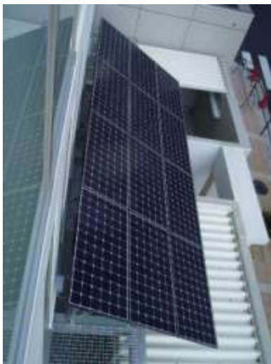
エネルギーを創出する設備 ：太陽光発電システム
