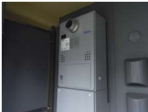
給湯する設備 ：線熱回収型給湯器（エコジョーズ）
