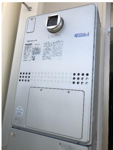
給湯設備：潜熱回収型給湯器
