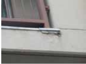
バルコニー ひび割れ
