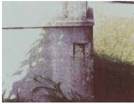
基礎 鉄筋の露出
