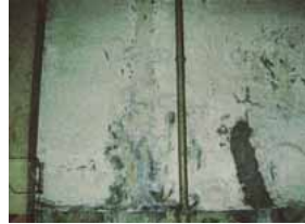
内壁 ひび割れ
