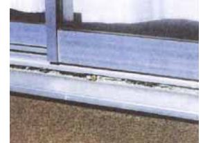
外壁 建具周囲の隙間
