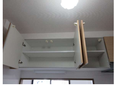
吊戸棚等における地震対策のための措置
