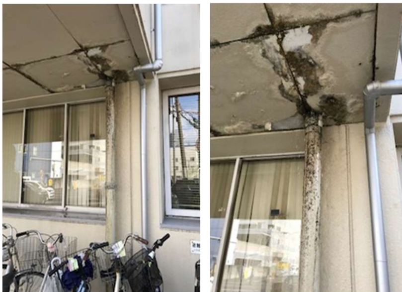
【漏水による天井仕上の腐食】
