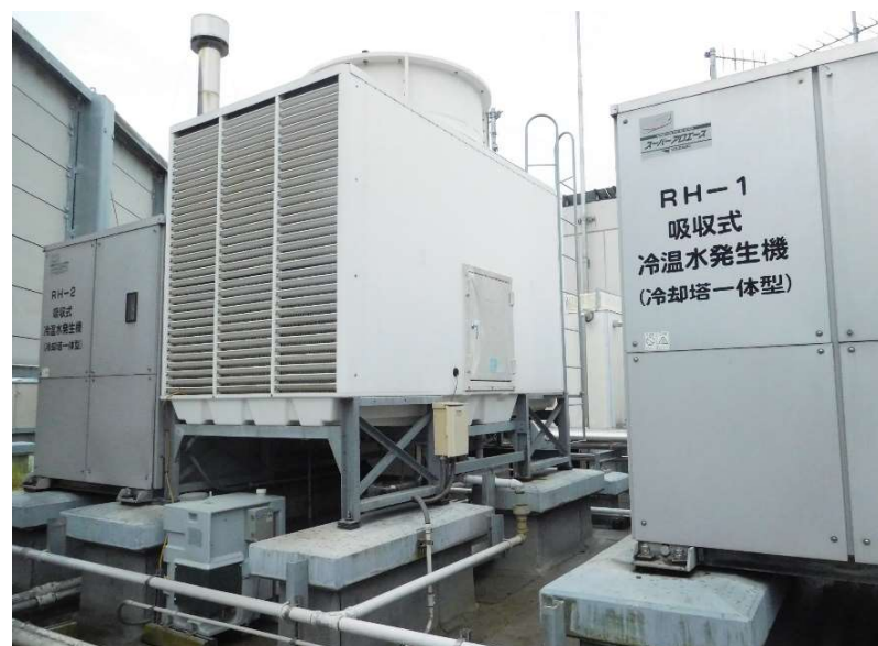
【冷温水発生器の経年劣化】
