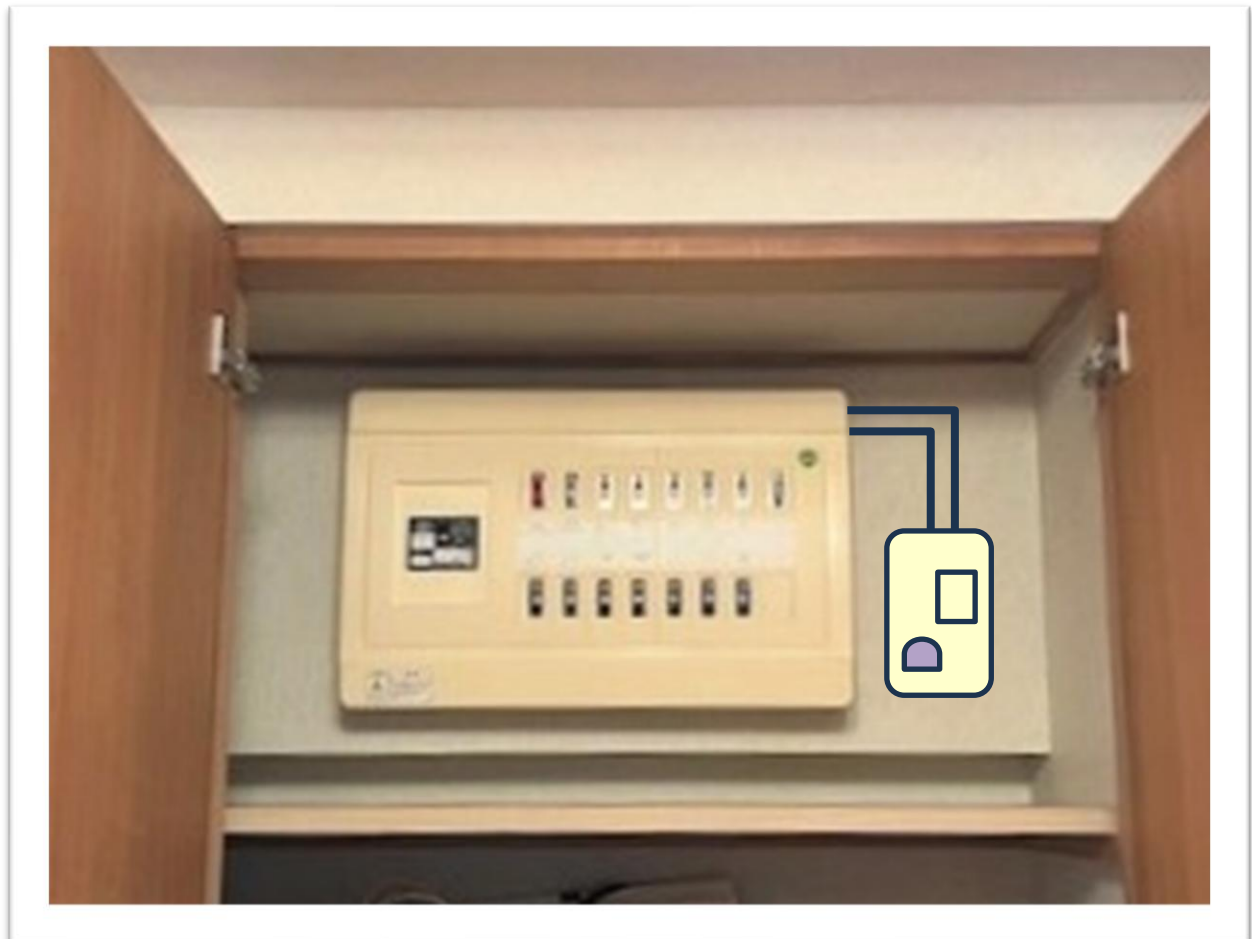
感震ブレーカー設置後の写真
