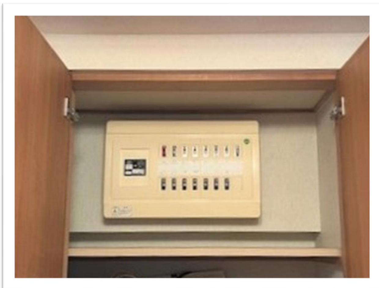
感震ブレーカー設置前の既設分電盤の写真
