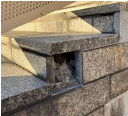
【階段の損傷状態】
