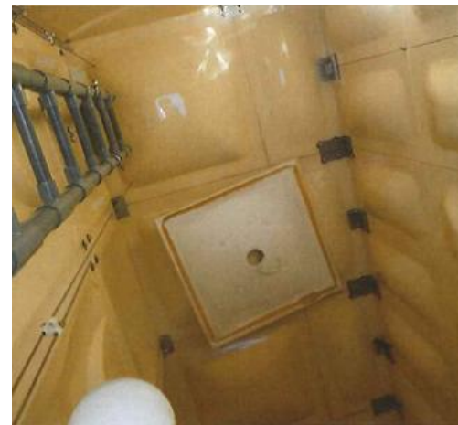
【天井パネルの脱落】
