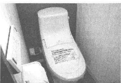
温水洗浄機能付き トイレ（1階・2階）
