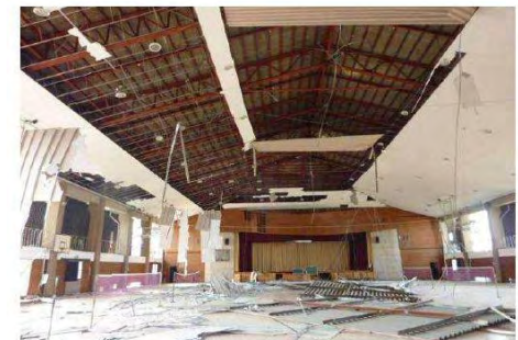
東日本大震災での天井脱落被害状況(出典:文部科学省)
