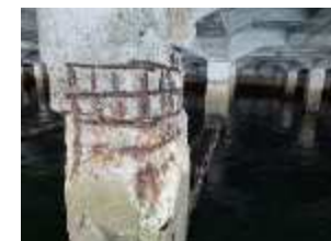
劣化が進行している係留施設(岸壁、物揚場)等の補修 市民利用施設等の緊急的な安全対策
