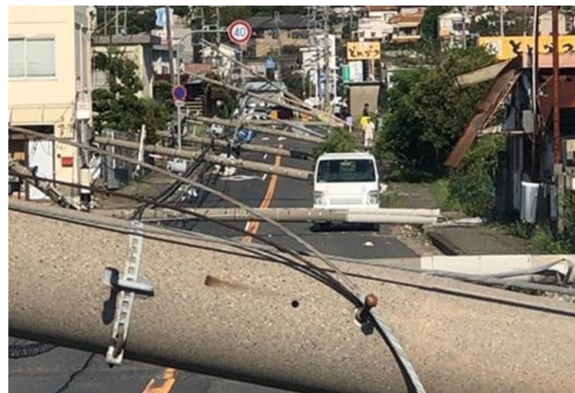
■台風21号被災状況（2018年）
