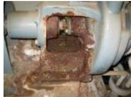
劣化が進行している設備(ポンプ)の事例 市民利用施設等の緊急的な安全対策
