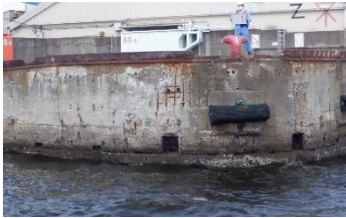
劣化が進行している係留施設(岸壁、物揚場)等の補修 市民利用施設等の緊急的な安全対策
