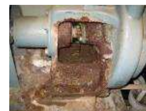
劣化が進行している設備(ポンプ)の事例 市民利用施設等の緊急的な安全対策
