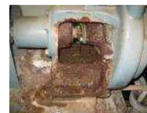
劣化が進行している設備(ポンプ)の事例
