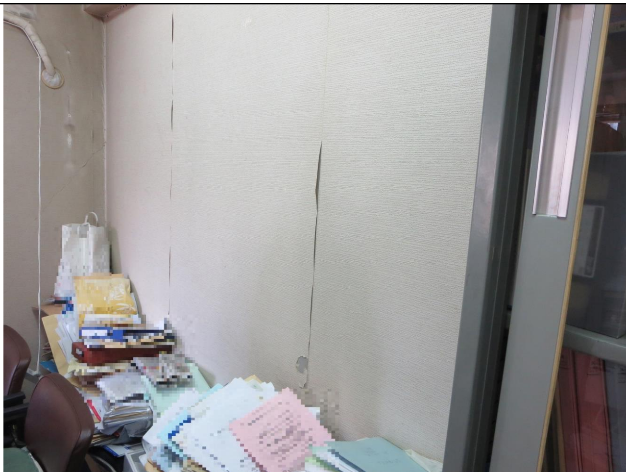
⑦クロス剥がれ（部屋奥側）
