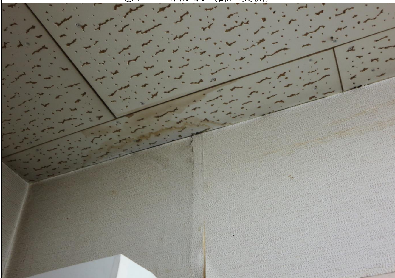
⑧天井部分染み・クロス剥がれ（玄関付近）
