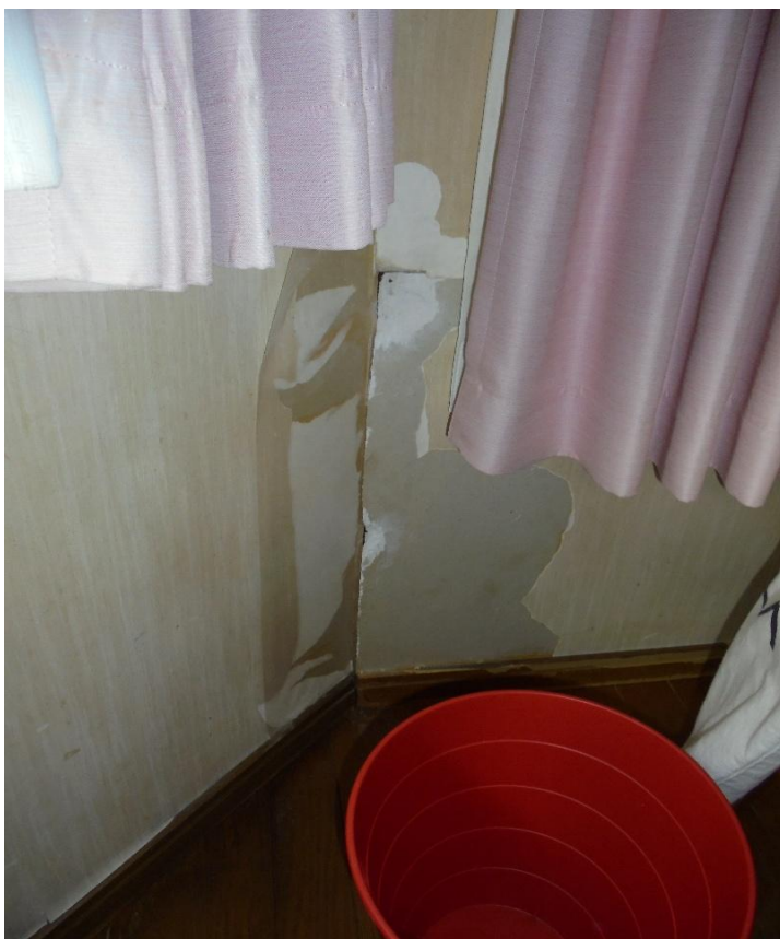
⑫2階リビングダイニング（南西側壁紙の剥がれ）
