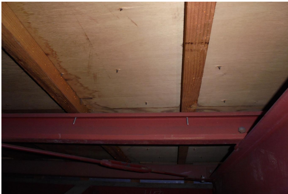
②3階屋根裏収納 雨漏り跡
